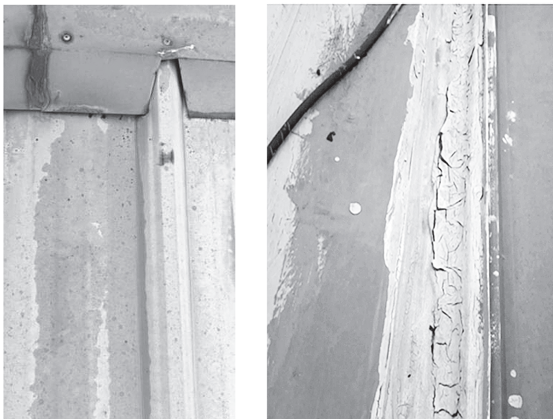
图 1-7 某钢结构建筑墙板、屋面板开裂渗漏
