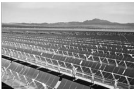
图 3-4 SEGS 项目采用镜槽收集太阳热量
